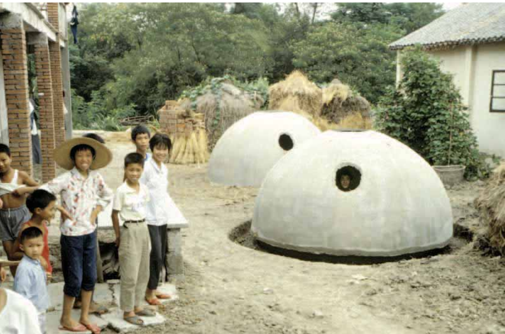
Proyecto de biogás que genera energía para una comunidad rural, China
